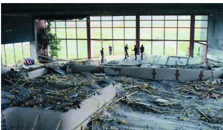
1985 versagte die abgehängte Betondecke eines Hallenbades im schweizerischen Uster. Die Aufhängungen der Decke aus nichtrostendem Stahl A2 zeigten rein äusserlich keinerlei Mängel, waren jedoch innerlich teilweise vollkommen durch Spannungsrissskorrosion zerstört.
