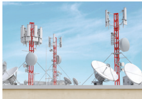
Antennen und Masten
