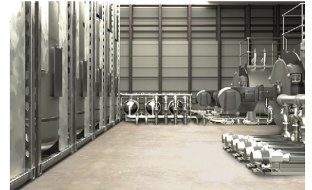
Chemie-Produktion mit Silos und Rohrleitungen
